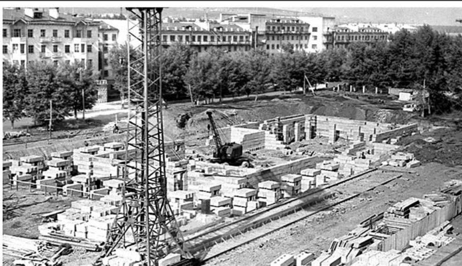
На строительство современного здания Новокузнецкого драматического театра, построенного по специальному проекту московских архитекторов, ушло целых шесть лет. На снимке: начало строительства – 1957 год. (Из фондов городского краеведческого музея).
